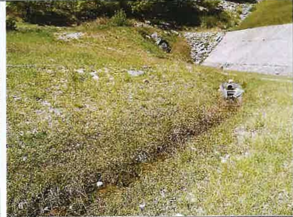
8 - Vue sur les drain de pied de barrage, restitution du débit au cours d'eau de la Laye
